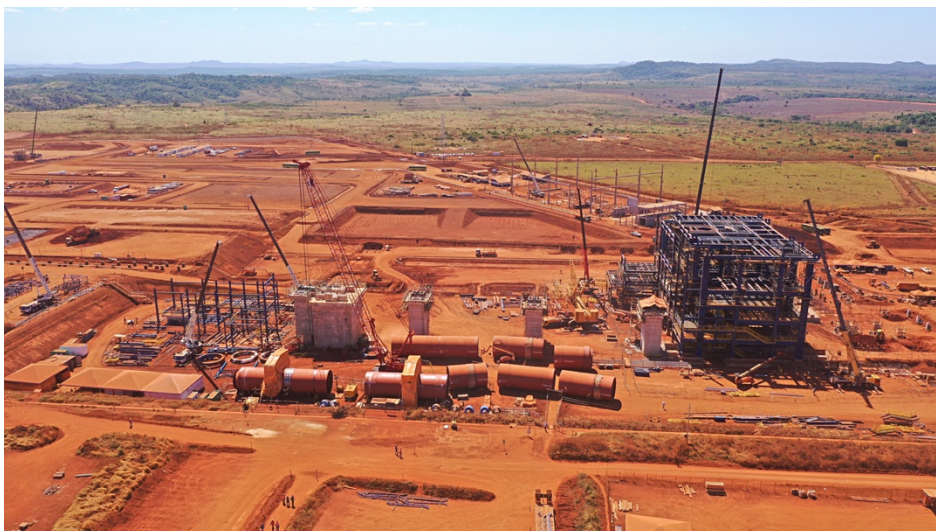
Figura 4 – Pilares do forno rotativo (calcinador), as peças individuais do calcinador, a montagem metálica do precipitador eletrostático e o forno elétrico.
