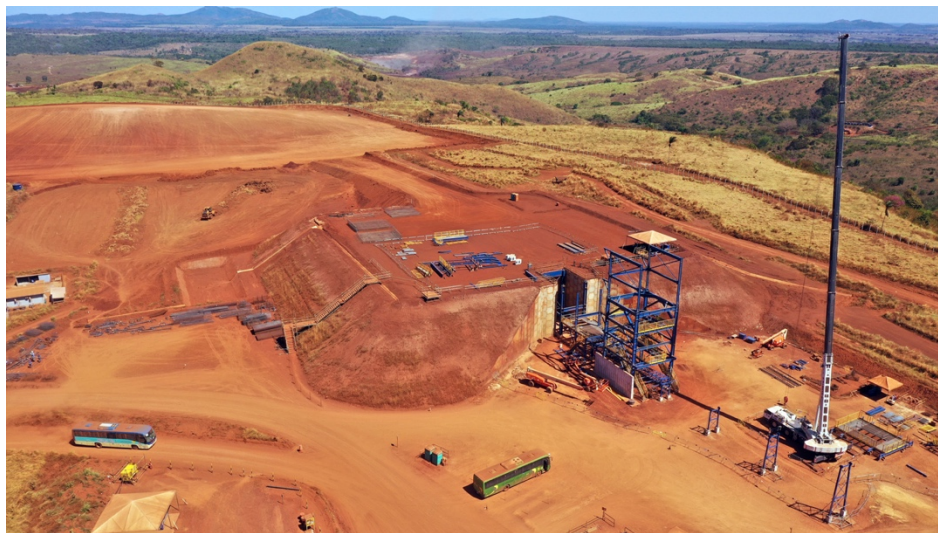
Figura 2 – O ROM pad, ROM bin e o britador primário
